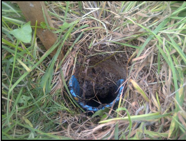
Photographie n°13 : Vue de l'ouvrage A12bis avant remise en état
